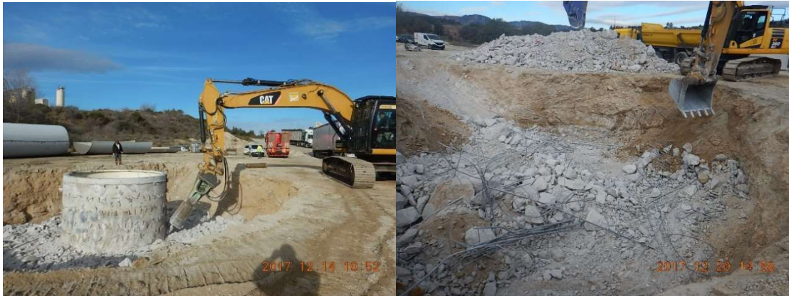
Figure 17 - Destruction de la fondation
