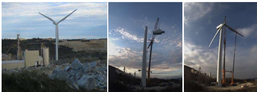
Figure 15 - Eolienne de Centernach Figure 16 - Démantèlement de l'éolienne
