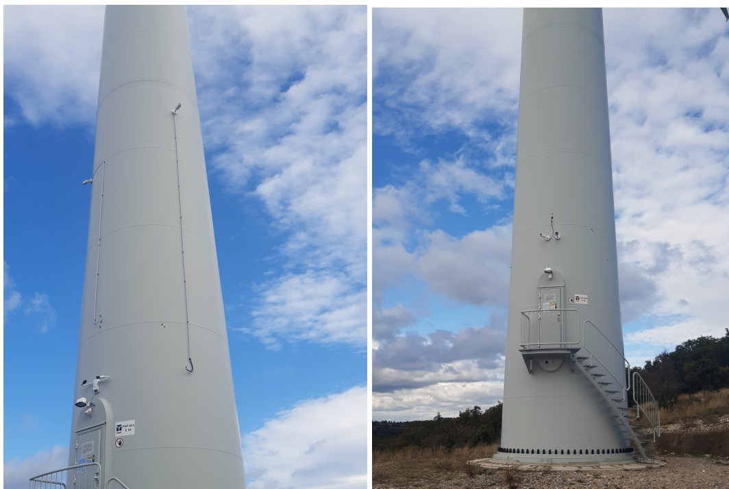
Caméras du Système de Détection Avifaune, Parc éolien du Cap Espigne, Hérault – 34, VALECO
