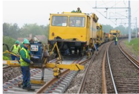
Longs Rails soudés sur traverses béton
