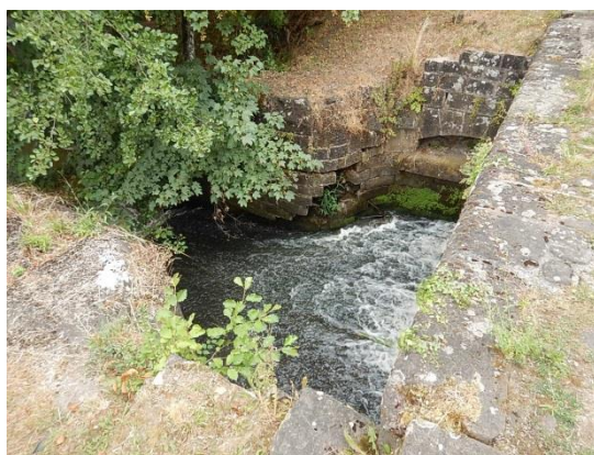
Fig. 14. Vue aval du coursier des désordres de maçonnerie
