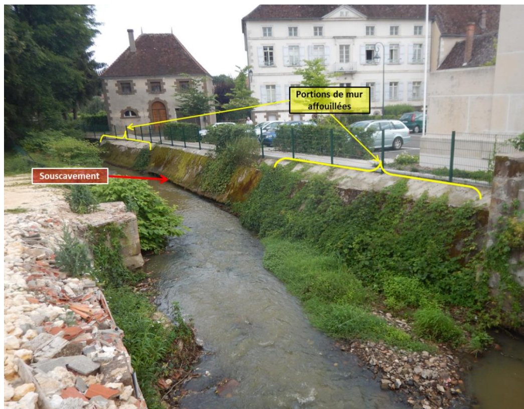
Fig. 25. Illustration des désordres observés sur le mur en rive droite
